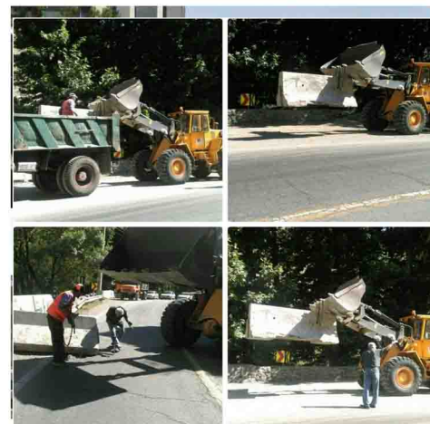
تخریب پایه های بتنی و سازه های غیرمجاز در آزادراه تهران - کرج.
